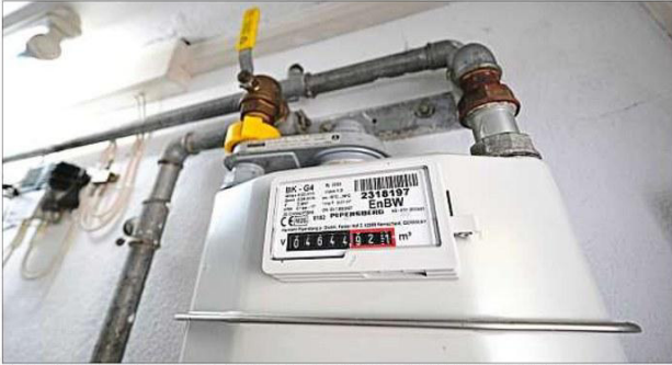
Per Verordnung sollen ungenutzte Einsparpotenziale bestehender Heizungen mittels einer Prüfung herausgefunden werden. Foto: Bernd Weißbrod/dpa
